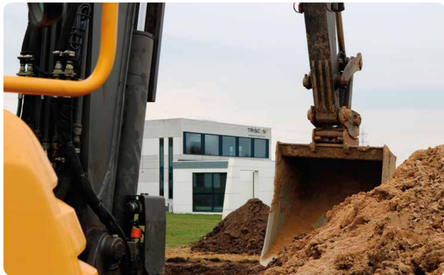
Så er vi igang! Første tegn på at der her kommer en tilbygning - samt 20 nye parkeringspladser
